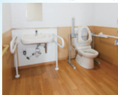
■トイレ◎各ユニットに2つずつ設置
